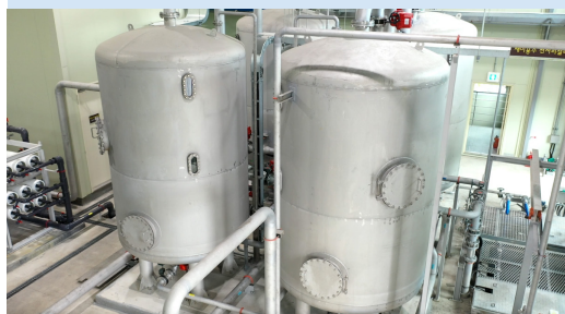
OO 식품공장 공업용수처리시설
